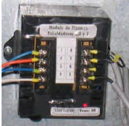
Figura G2. Modulo de Alarmas Escaldadoras 1,2 y 3 terminado
