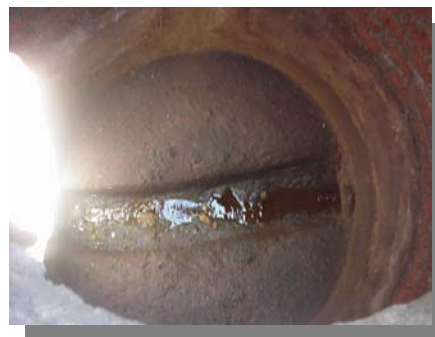
Pozo pluvial Zapamanga V etapa CII 51 con Cra 126
