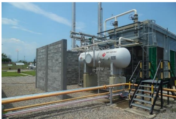
Figura 18. Sistema de refrigeración con propano.
