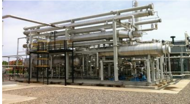
Figura 17. Unidad de control de punto de rocío de hidrocarburo
