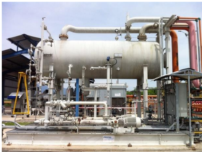
Figura 14. Separador de gas de entrada
