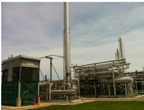
Figura 20. Sistema de estabilización de condensados
