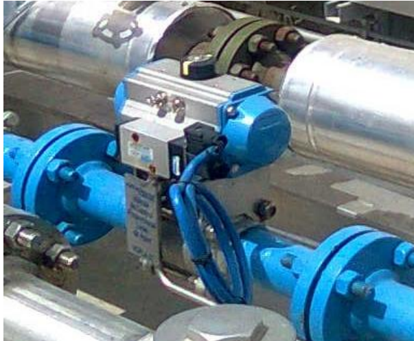
Foto 13. Válvula on/off para agua
