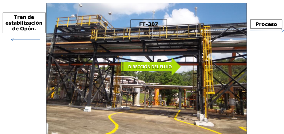
Figura 17: Ubicación del Sistema de Medición de Gas de recibo Opón.
