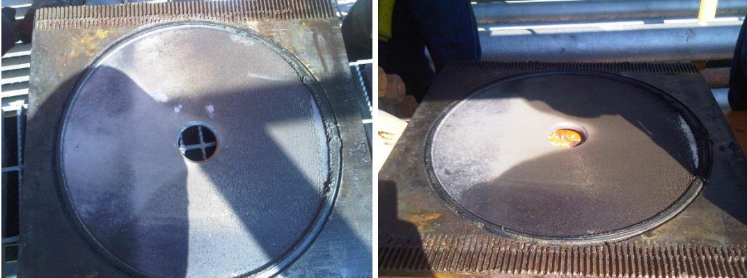
Figura 18: Estado actual de la Platina de Orificio.
