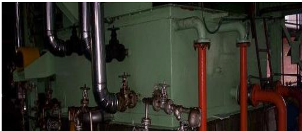
Figura 8. Tanque de Aceite crudo.
