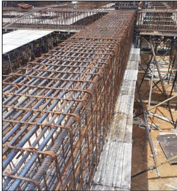
Figura 5. Armado de acero de refuerzo de una viga de sección 120X80 cm.
