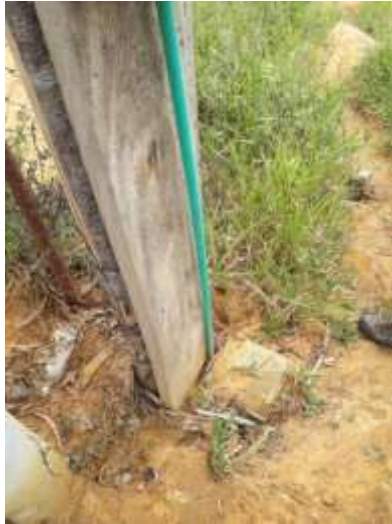
Figura 15. Puesta a tierra de una instalación temporal en Bucaramanga.
