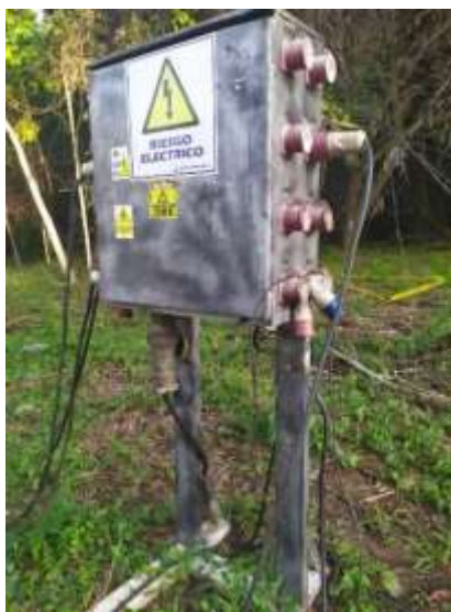
Figura 4. Tablero de distribución de provisional de obra
