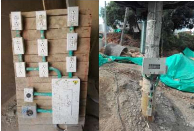
Figura 12. Registro fotográfico de tableros usados en provisionales de obra en la ciudad de Bucaramanga
