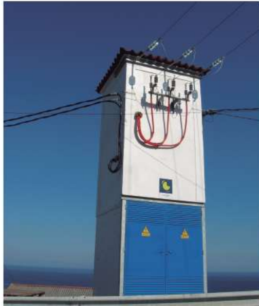
Figura 10. Centro de transformación a la intemperie.
