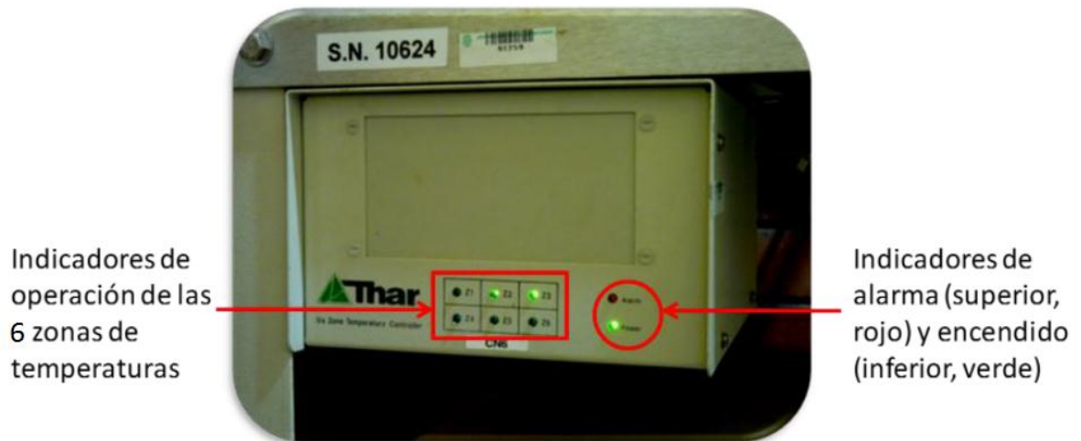
Figura 13. Controlador de Temperaturas, CN6 .
