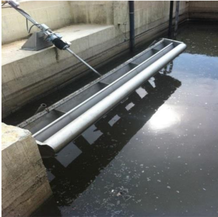
Figura 6. Decantador de agua superficial.
