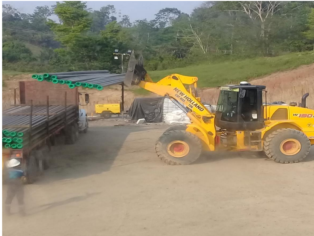
Figura 5. Puesto de trabajo del operador de montacargas.
