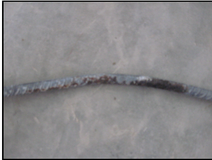
Fotografía 29. Varilla de refuerzo viga contaminada.
