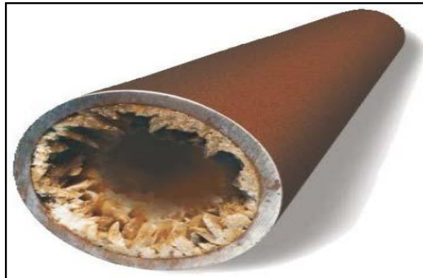
Figura 23. Acumulación de incrustaciones dentro de la tubería
