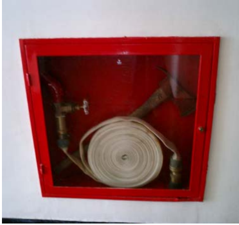
Imagen N° 6 Red Contra incendios.
