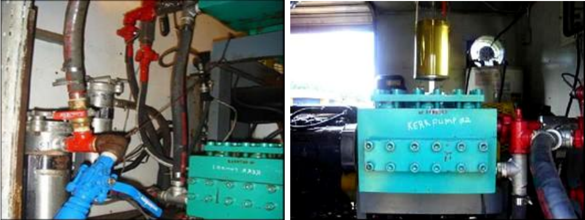
Figura 7. Filtros de 5 y 10 micrones y Bomba de Presión de la Unidad.
