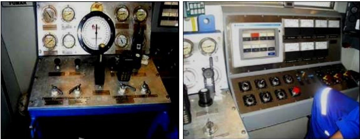
Figura 8. Cabina de Control.
