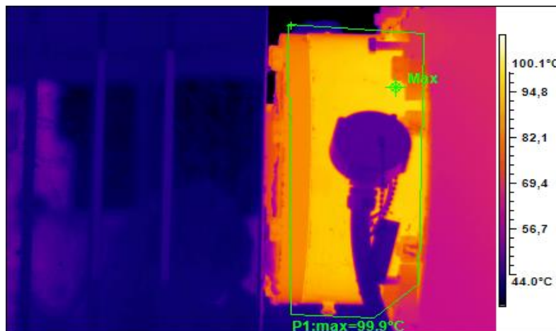
Imagen 4. Imagen térmica de chumacera en bomba de estación Monterrey
