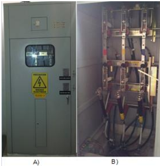
Figura 14. Seccionador. A) Gabinete del seccionador. B) Vista del seccionador.
