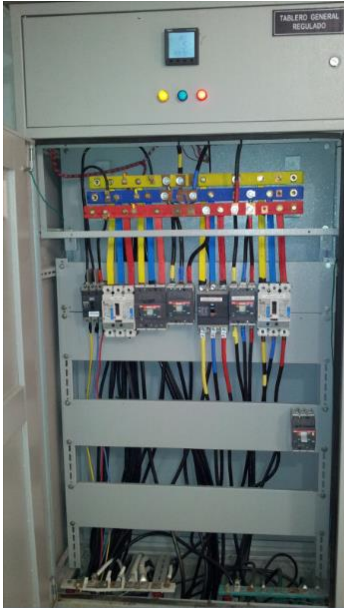
Figura 23. Tablero General de Regulado.
