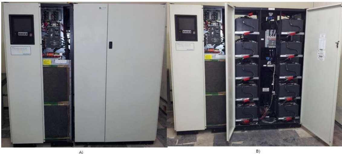
Figura 25. Gabinete Banco de Condensadores. A) Banco de condensadores B) Banco de condensadores con las puertas abiertas.
