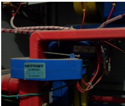
Figura 15. Transformadores de corriente.
