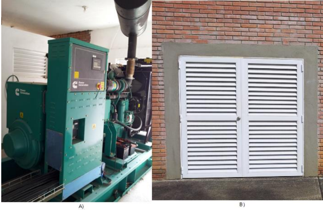
Figura 28. Planta de emergencia Camilo Torres. A) Vista de la planta eléctrica. B) Lugar donde se encuentra con puertas cerradas.
