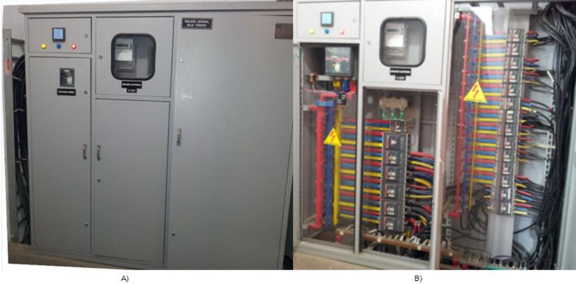
Figura 17. Tablero general de baja tensión. A) Gabinete con puertas cerradas B) Gabinete abierto.
