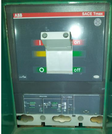
Figura 29. Totalizador de la planta de emergencia.
