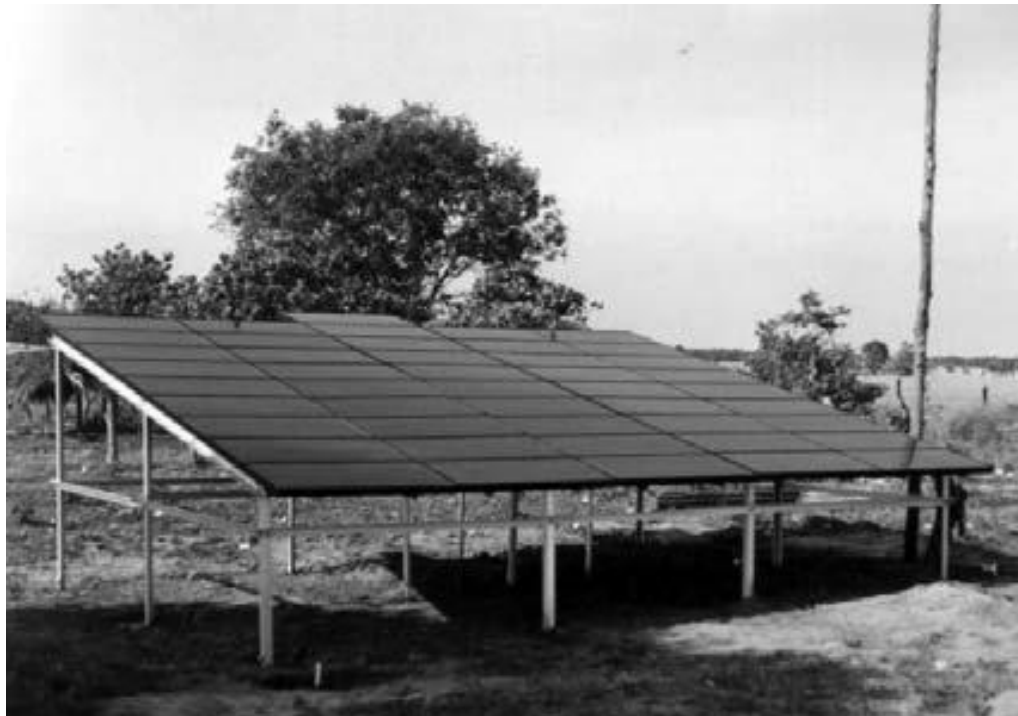
Figura 5. Sistema Fotovoltaico instalado por el antiguo ICEL, hoy IPSE.
