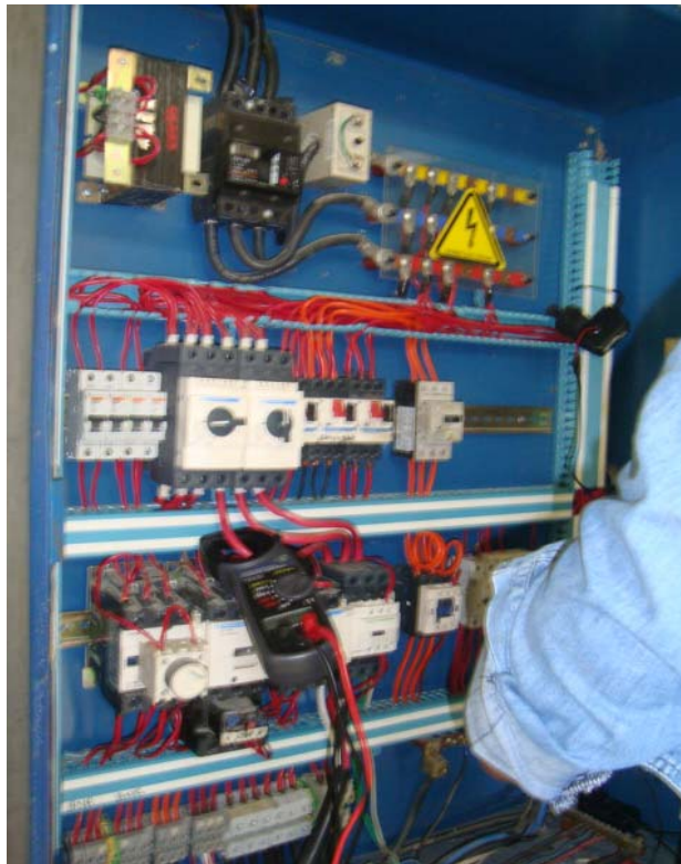
Figura 53. Toma de medida de amperaje a motores
