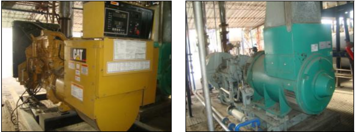
Figura 31. Planta Caterpillar y Turbina Shinko.
