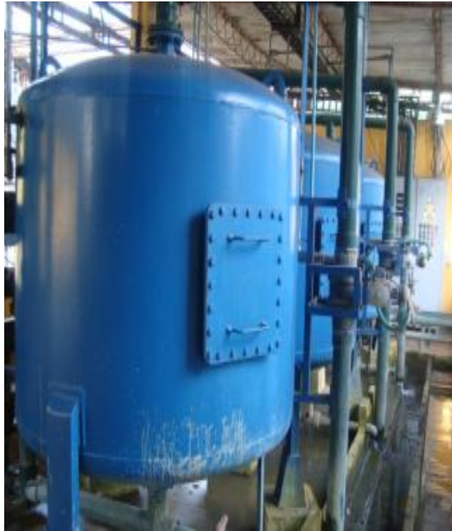
Figura 27. Filtros para tratamiento de agua
