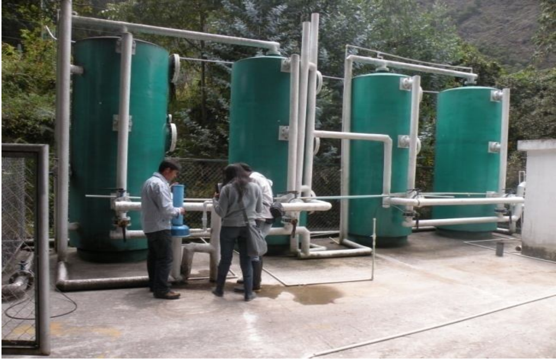
Foto F11. Vista planta de potabilización del acueducto urbano de Arcabuco.
