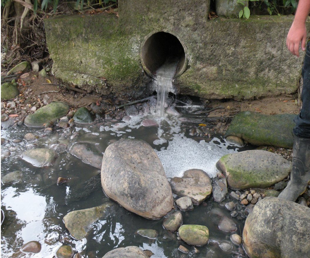
Foto F2. Descarga de la PTAR Togüí que vierte sobre el brazo derecho del Río Ubaza.
