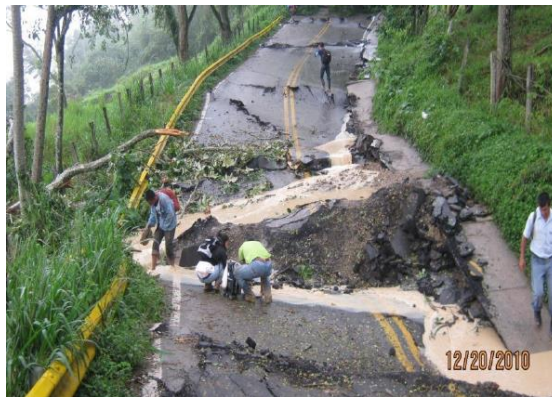
Figura 3. Falla en la vía Bucaramanga-Barrancabermeja, año 2010.
