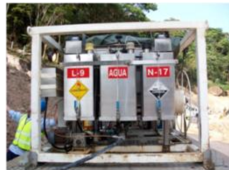
d) Unidad de bombeo de emulsión
