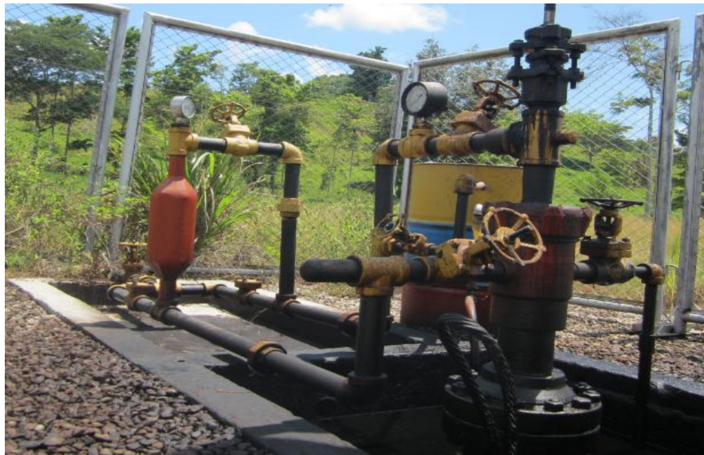
Figura 47. Facilidad de superficie para la recirculación de químicos utilizada en CEC.
