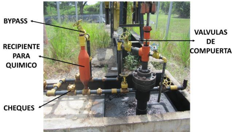
Figura 48. Componentes del sistema de recirculación utilizado en CEC
