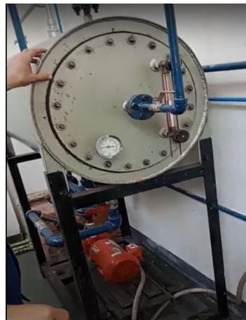
Tanque de Condensados- Tanque de Alimentación de Agua T-101
