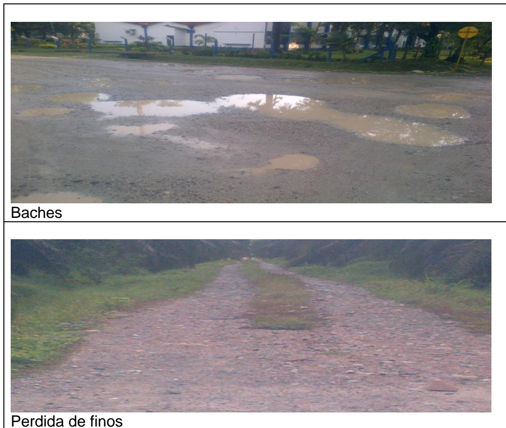
Figura 10. Baches, pérdidas de finos y alcantarillados obstruidos
