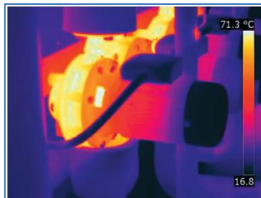
Figura 16. Termograma de un motor eléctrico.
