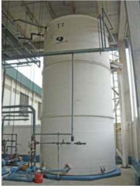
Tanque Ecuación Principal
