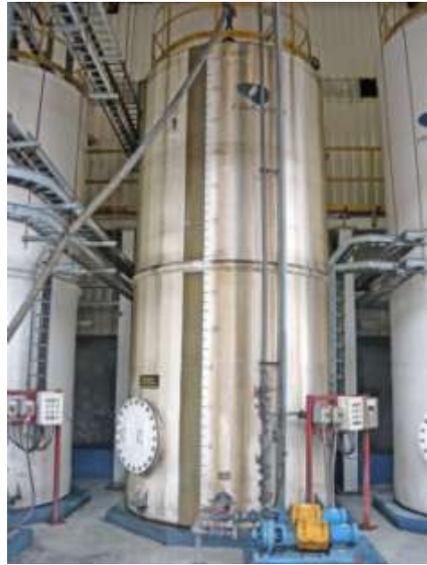
Tanque de Ecuación Auxiliar
