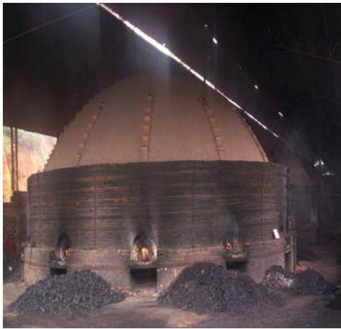
Figura 1. Horno colmena Fotos cortesía Ladrillera
