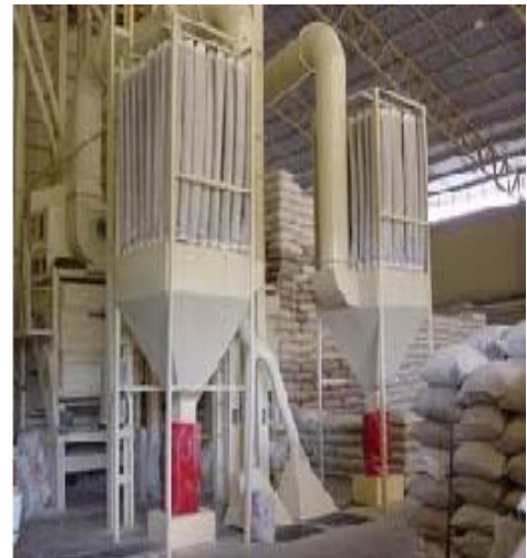
Figura 12. Filtros de mangas
