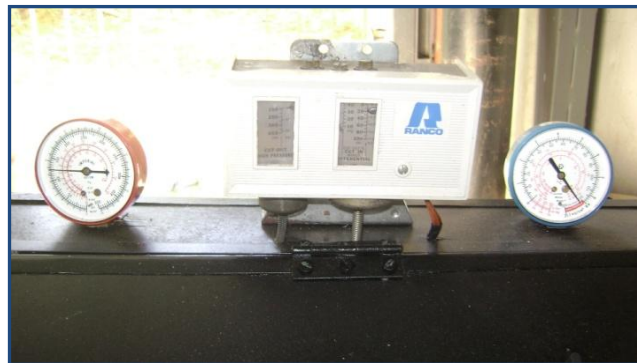
Figura 26. Medidores de presión.
