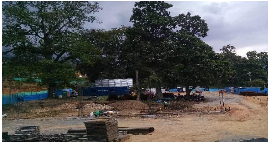
Figura 24. Árboles sin talar en obra.
