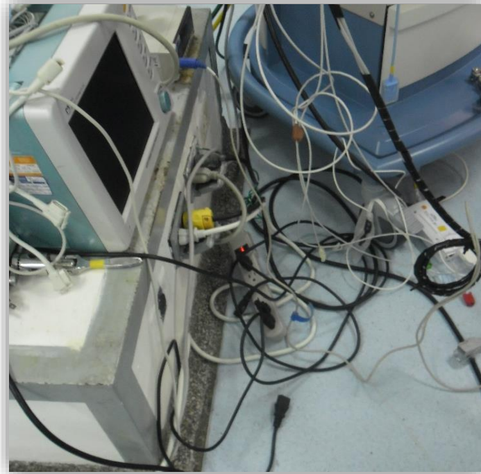
Figura 12. Suministro de energía eléctrica
