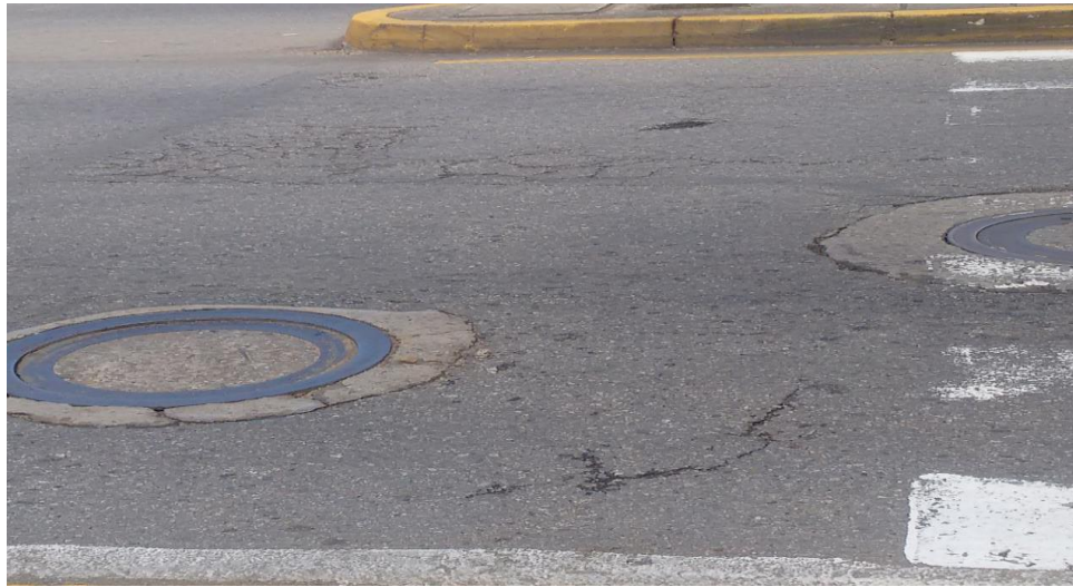
Figura 18. Fisuras en la calle 56 con cra 3 33.
