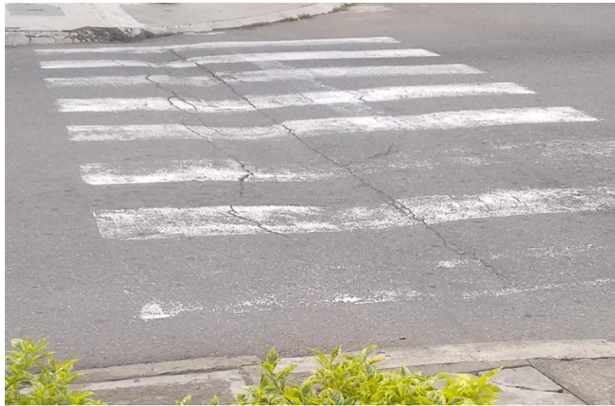
Figura 19. Hundimiento en la calle 42 con cra 35.
