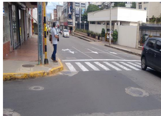
Figura 23. Parche en la calle 35 con cra 21.
