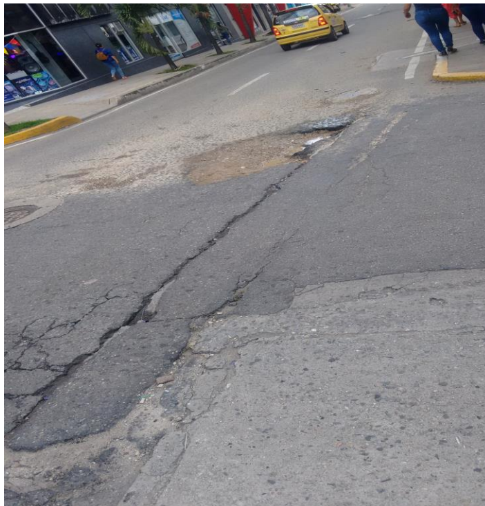
Figura 24. Bache en la calle 34 con cra 22.
