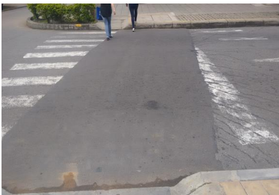
Figura 22. Parche en la calle 48 con cra 35.
