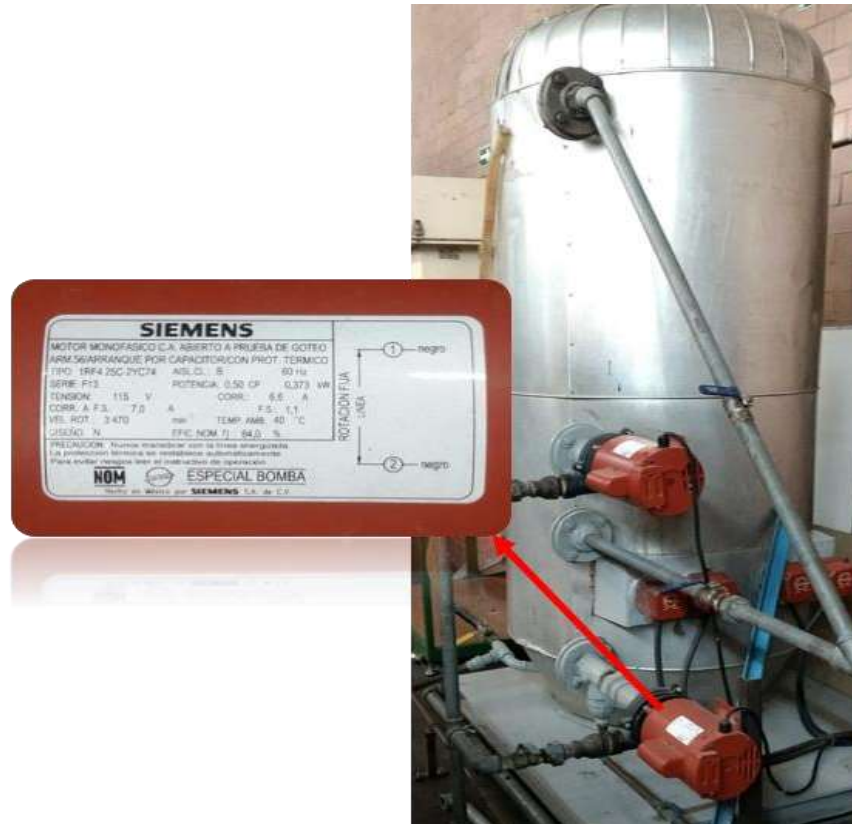
Figura 16. Caldera y equipos de bombeo.
