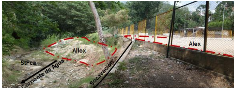
Fotografía 51. Margen izquierdo de la Quebrada Suratoque. Vista NE-SE, evidencia de socavación lateral y reptación producto de la erosión.
