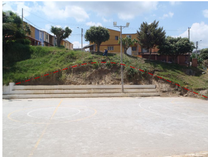
Fotografía 52. Barrió la Castellana. Visto al SE. Panorámica en la cual se observa corona de deslizamiento (línea punteada) por encima de la cancha.
