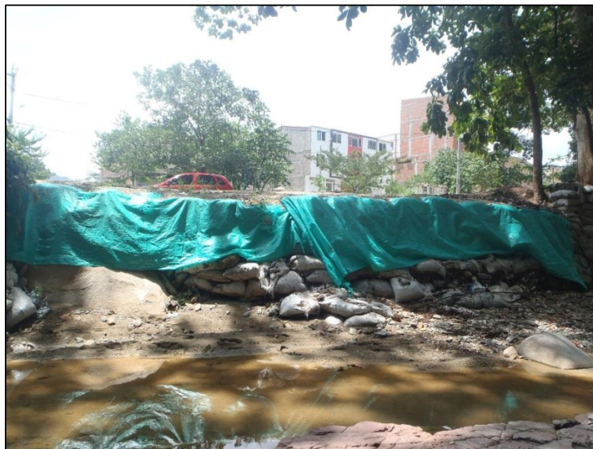
Fotografía 14. Margen derecho de la Quebrada Suratoque. Visto al NE, desde el punto se observa estructura de tipo antrópico, la cual intenta controlar la erosión y socavación que se ha generado sobre el margen de la Quebrada en este sector del área de estudio.
