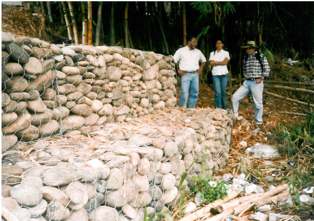
Foto 8. Obras de Protección en gavión para el control de la erosión. Obsérvese la malla hexagonal y el cuerpo del gavión de 2X2X1.
