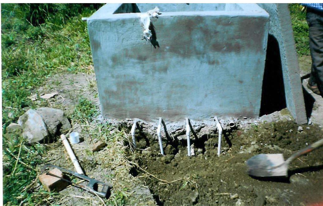
Foto 6. Tanquilla de distribución. Obsérvese las conexiones de las conducciones domiciliarias a la tanquilla.
