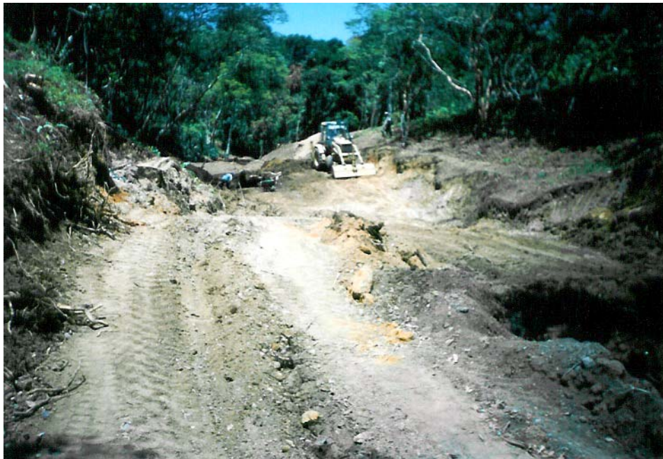
Foto 1. Excavación zona inundable presa quebrada Hoya de Perros, Municipio de San Gil.
