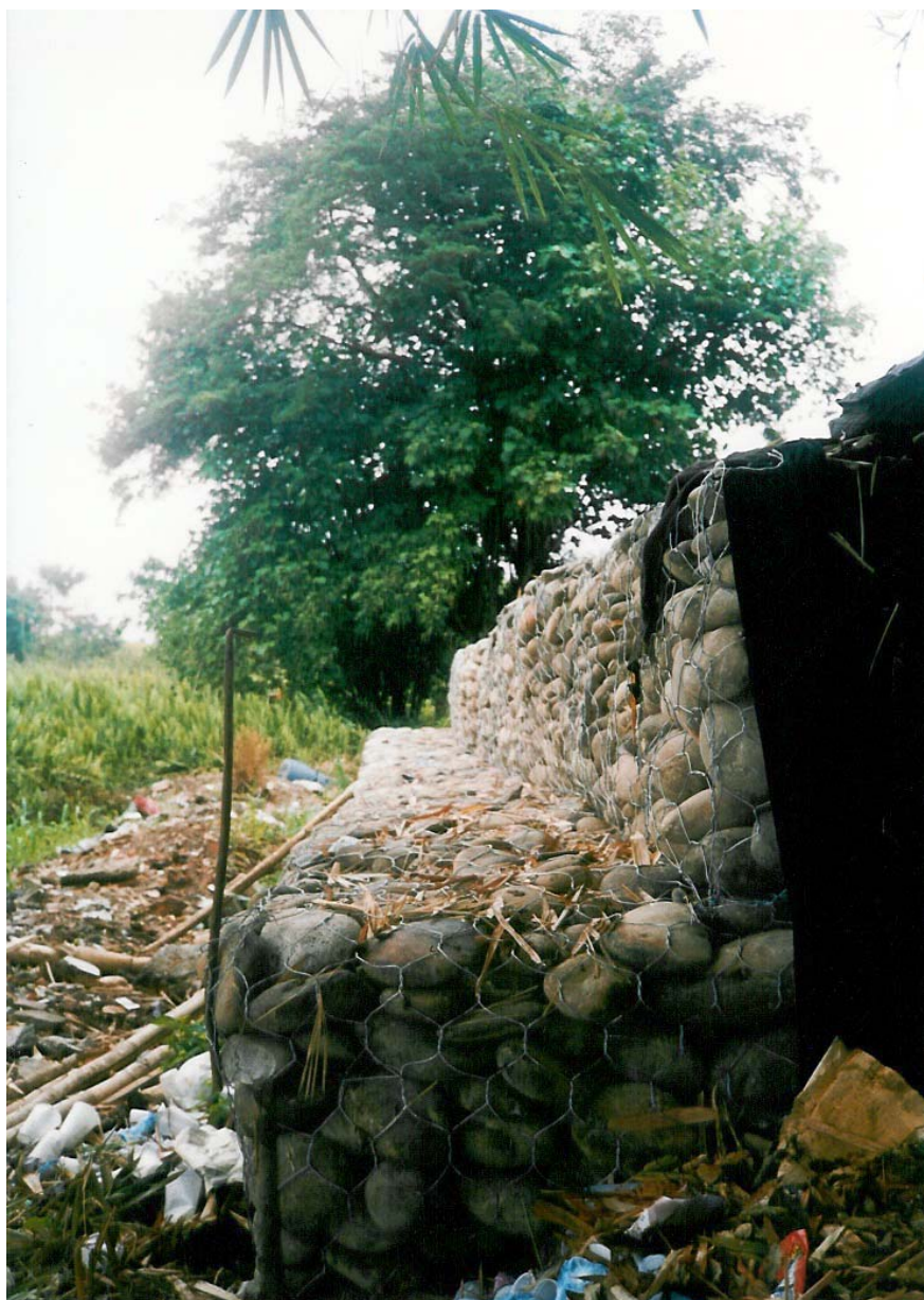
Foto 9. Obras de Protección en gaviones. Se realizó un llamado de atención en forma verbal al contratista por no efectuar la limpieza de residuos y escombros propios de la construcción los cuales se observan en la parte izquierda de la foto..
