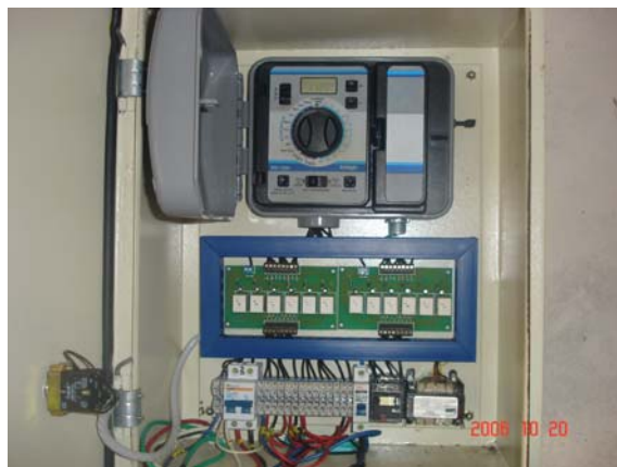
Foto 6. Sistema de control eléctrico.
