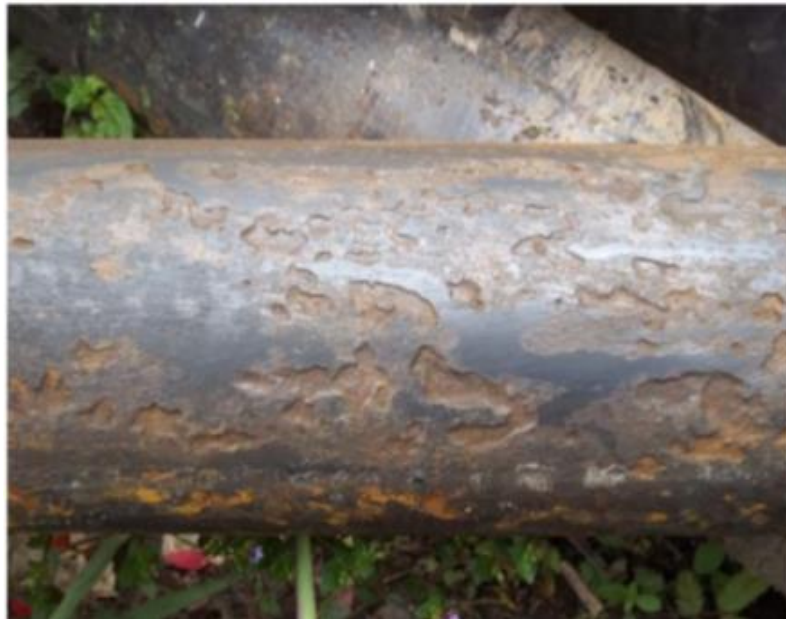
Figura 25. Corrosión por CO 2
