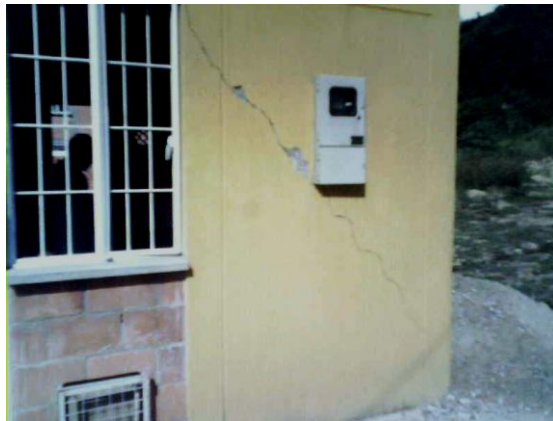
Fotografía N° 6. Fachada de vivienda afectada. Fuente El autor.
