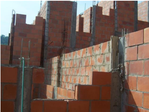
Fotografía N° 4. Casa 33 y 34 de la manzana B de la etapa 9 Presentan junta, mientras que en las casas anteriores de la misma manzana no la presentan. Fuente El Autor.
