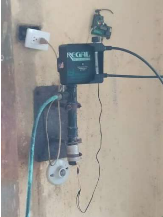
Figura 26: Dosificador de Cloro
