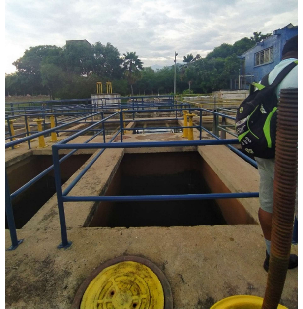
Figura 38: Filtros y sedimentador
