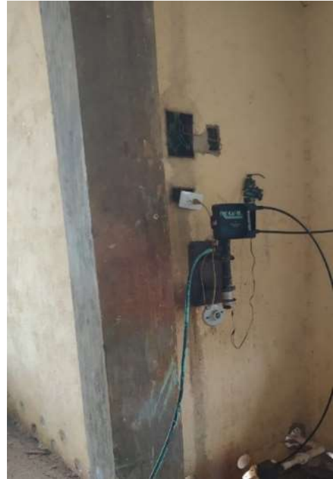
Figura 36: Dosificador y condiciones eléctricas
