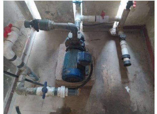
Figura 25: Bomba Del tanque.
