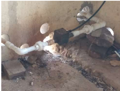
Figura 34: Suministro del cloro al agua
