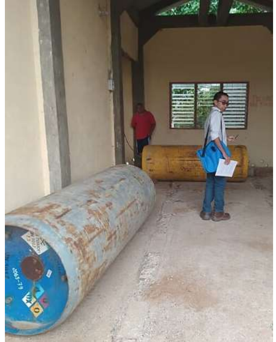
Figura 27: Tanques de Cloro
