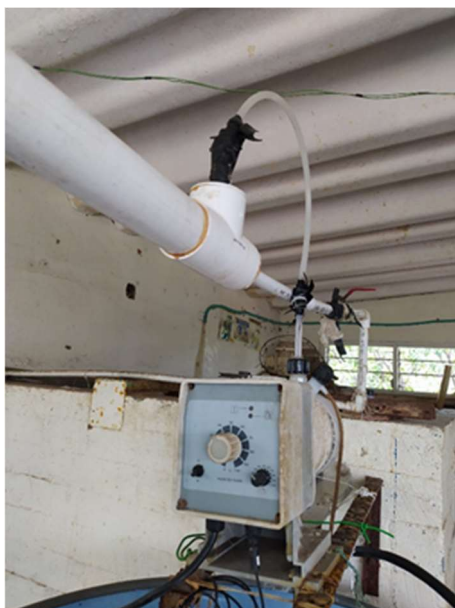
Figura 44: Dosificador marca EMEC
