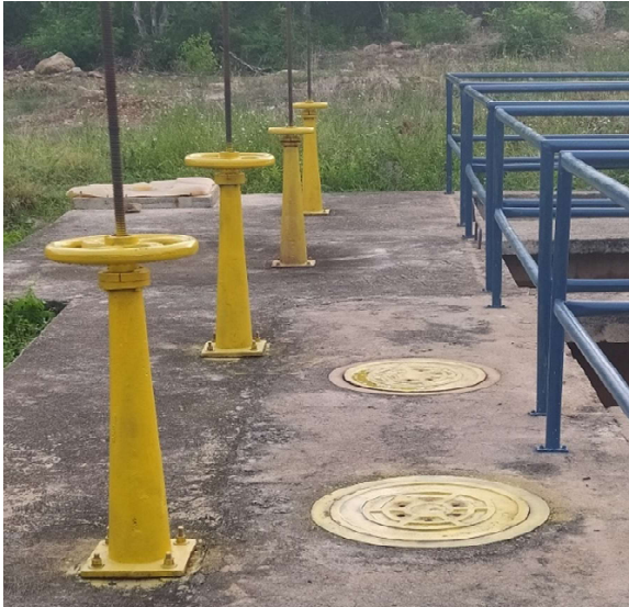
Figura 37: Válvulas de salida de los filtros
