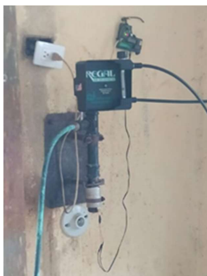
Figura 50: Dosificador de Cloro
