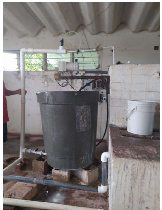
Figura 17: Tanque se suministró con Dosificador
