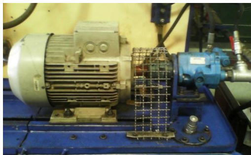
Figura 196. Montaje Bomba-motor utilizados para el modelo.
