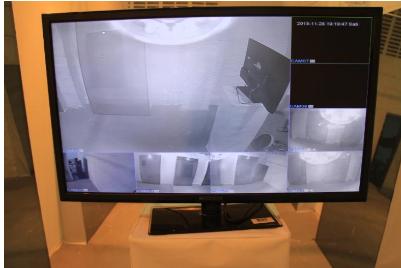
Figura 13. Fotografía televisor en funcionamiento con el sistema de seguridadl 29
