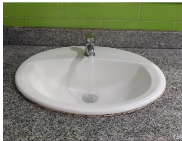
Figura 11. Grifo con fuga y alta presión baño hombres zona laboratorios.
