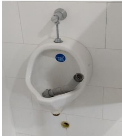
Figura 10. Orinal con fuga y falta de tubería baño hombres edificio bachillerato.
