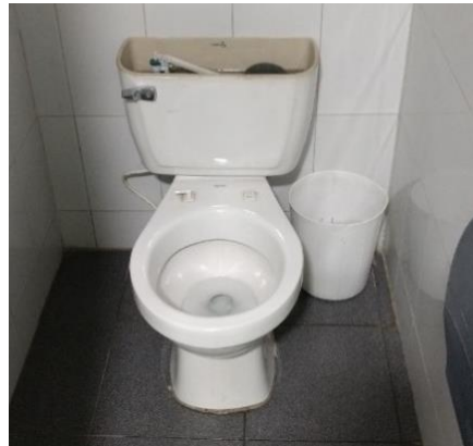
Figura 8. Inodoro en mal estado baño hombres zona laboratorios.
