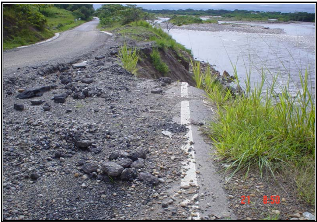
Fotografía 50. Gavión en concreto construido en el año 2000 para proteger la orilla izquierda. Se encuentra destruido al igual que los hexapodos que no fueron amarrados entre sí.
