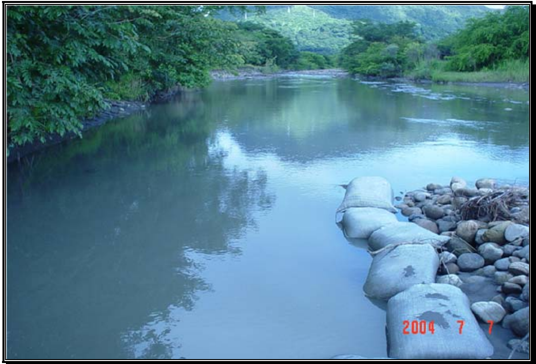
Fotografía 27. Jarillón con bolsas de arena y gravas para la entrada de agua al canal El Remanso.
