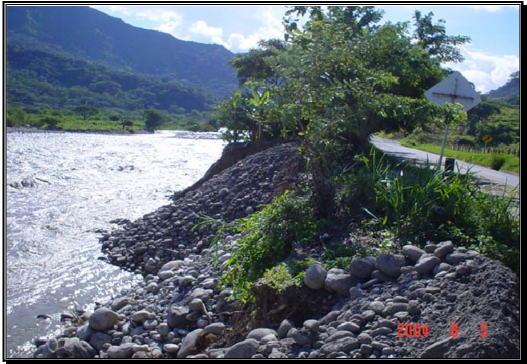
Fotografía 21. Sobretamaños de material del río colocados junto al talud para proteger la banca de la vía a Pore.
