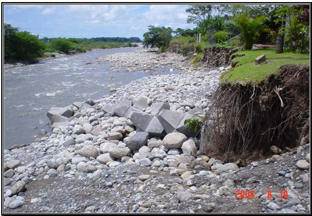
Fotografía 100. Material recostado sobre el talud en la Casa del Río y hexápodos para reforzar e impedir el golpe del flujo en la base de la orilla derecha.
