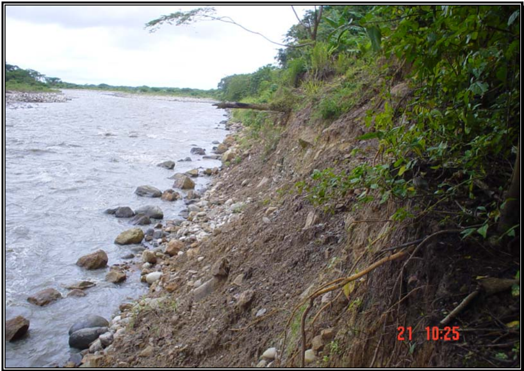
Fotografía 10. Altura de 6 a 8 metros en el talud del Río Cravo Sur, frente a Yopal.
