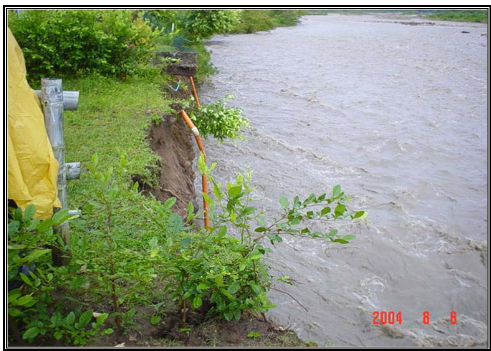
Fotografía 96. Talud de la urbanización La Casa del Río con la tubería de drenaje caída sobre e cauce después de la creciete de agosto de 2004.
