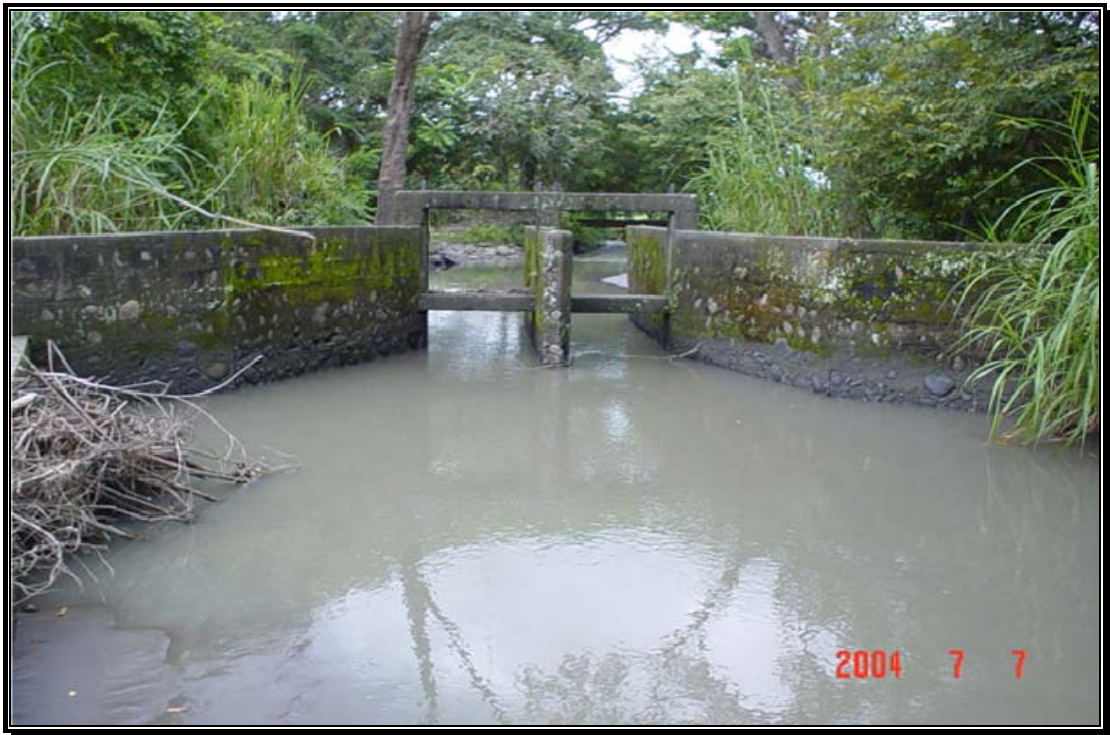
Fotografía 32. Estructura de control o compuerta a la entrada del canal de Matepantano.
