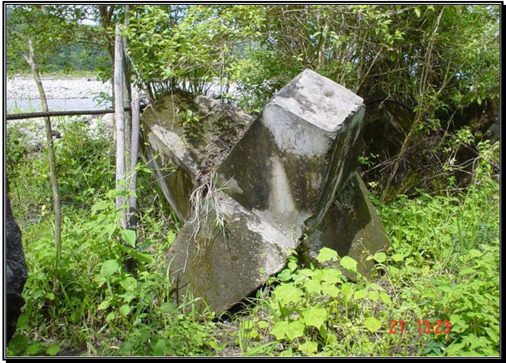
Fotografía 69. Hilera de hexápodos de gran tamaño colocados para proteger la margen derecha aguas abajo del canal El Remanso.
