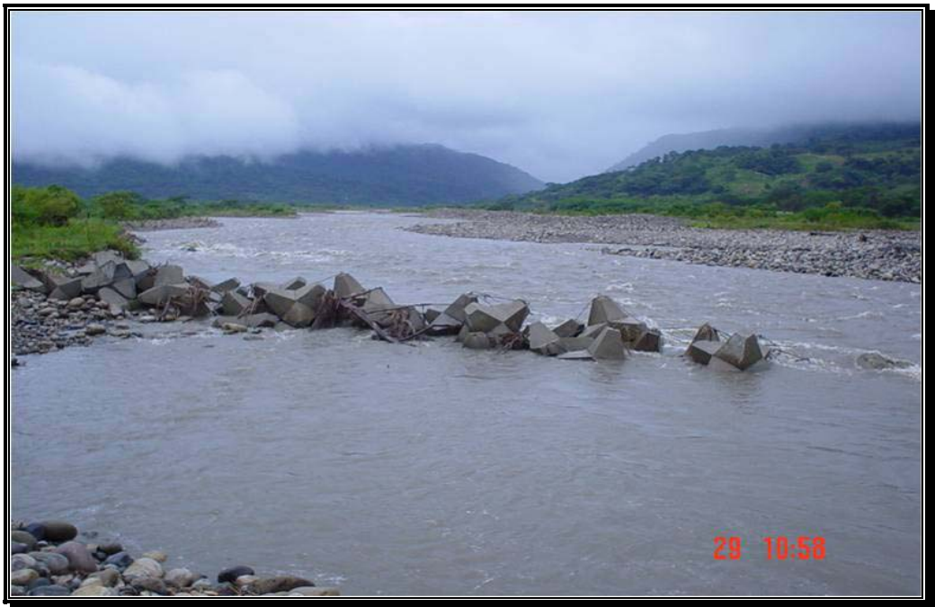
Fotografía 70. Hexápodos en forma de espolones aguas abajo del canal El Remanso.
