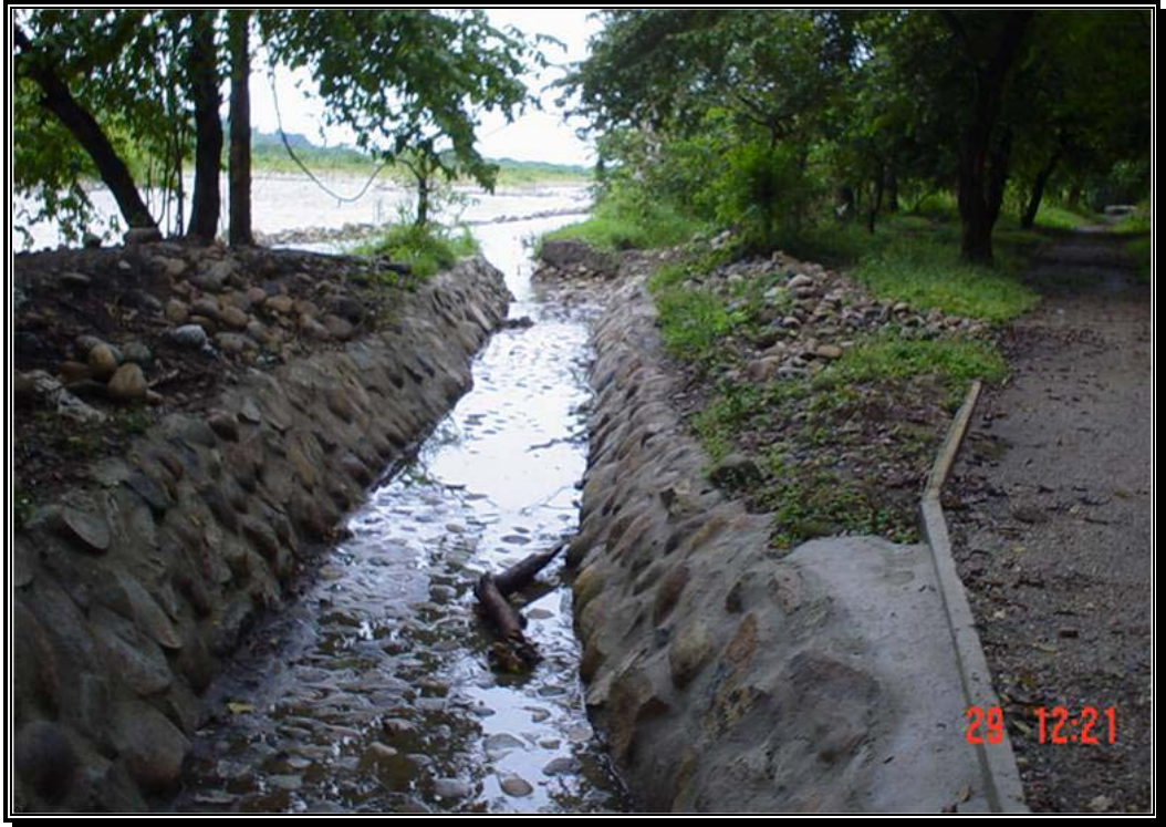
Fotografía 105. Canal en piedra pegada, recomendado para la conducción en el sistema de canales.
