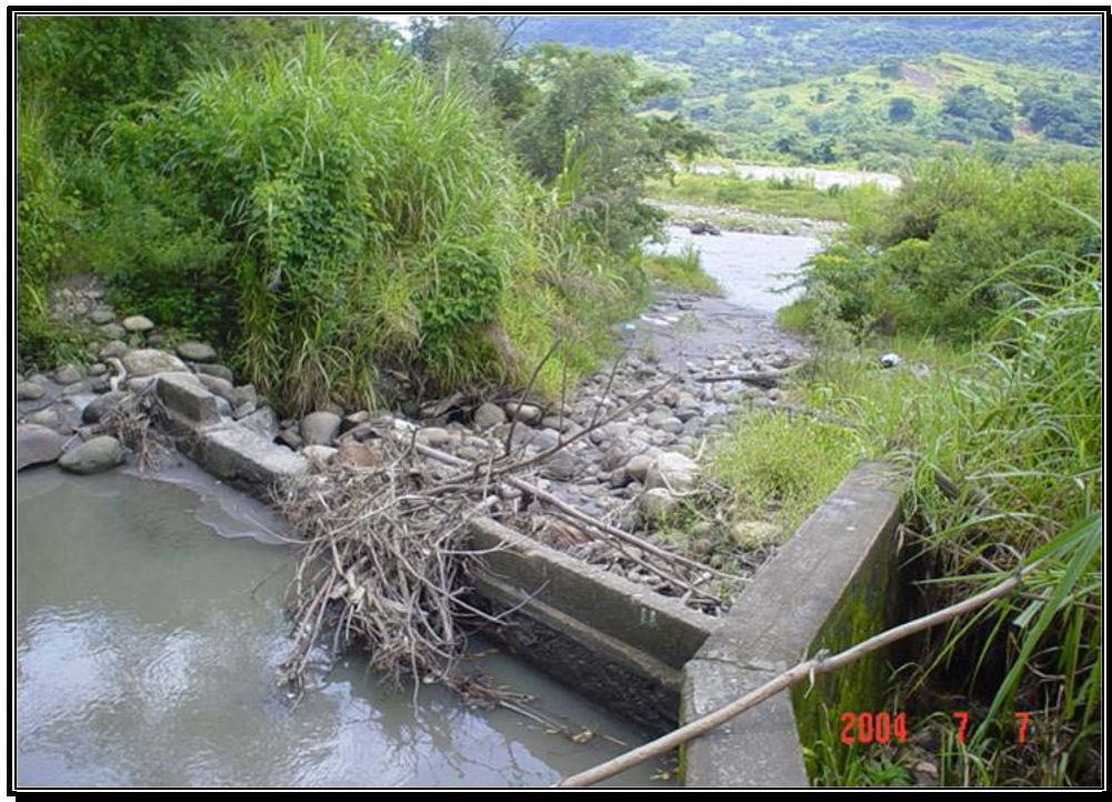
Fotografía 78. Estructura para la salida de agua por exceso de agua junto a la compuerta del canal de Matepantano.
