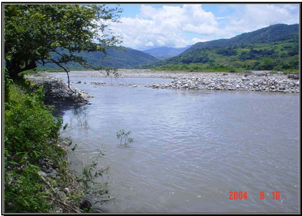
Fotografía 102. Dique construido en la boca de entrada al brazo derecho para proteger el talud de la urbanización La Casa del Río.
