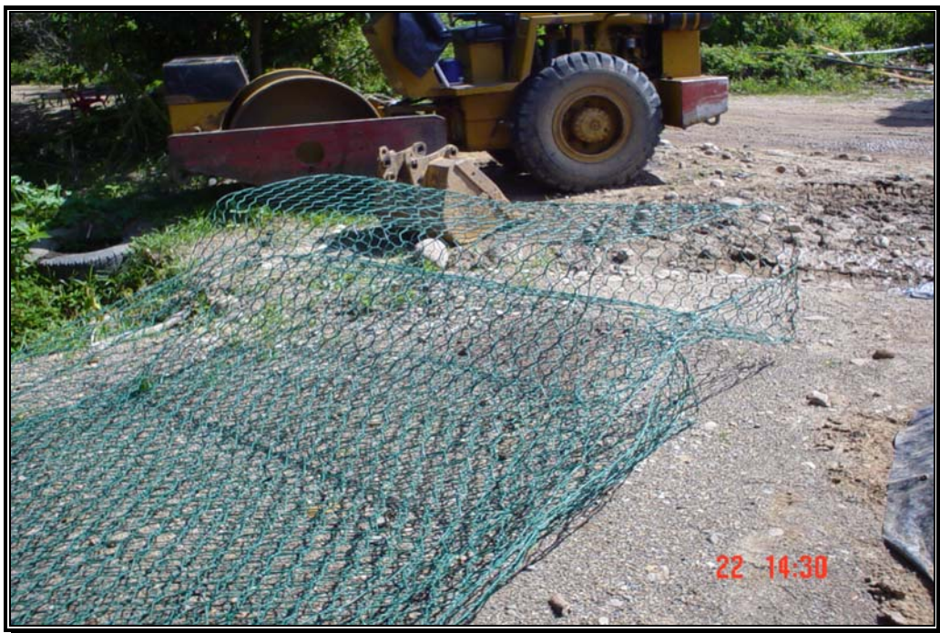
Fotografía 82. Maquinaria especializada para las obras y mallas especiales para el colchón reno.
