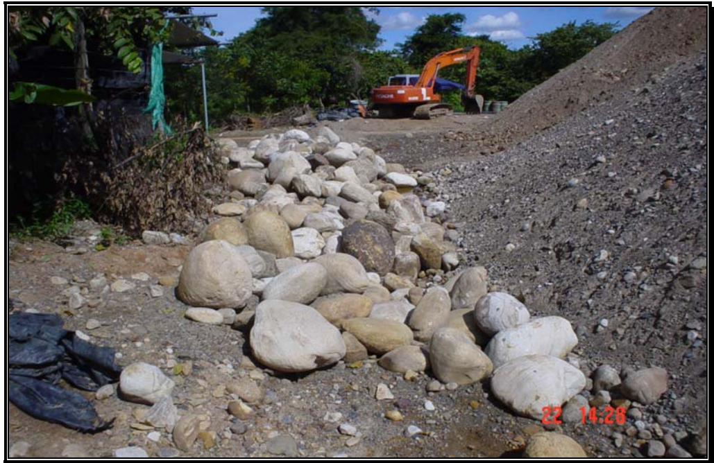
Fotografía 81. Maquinaria especializada para el desarrollo de actividades de excavación y reconfiguración del lecho. Material relleno del dique.
