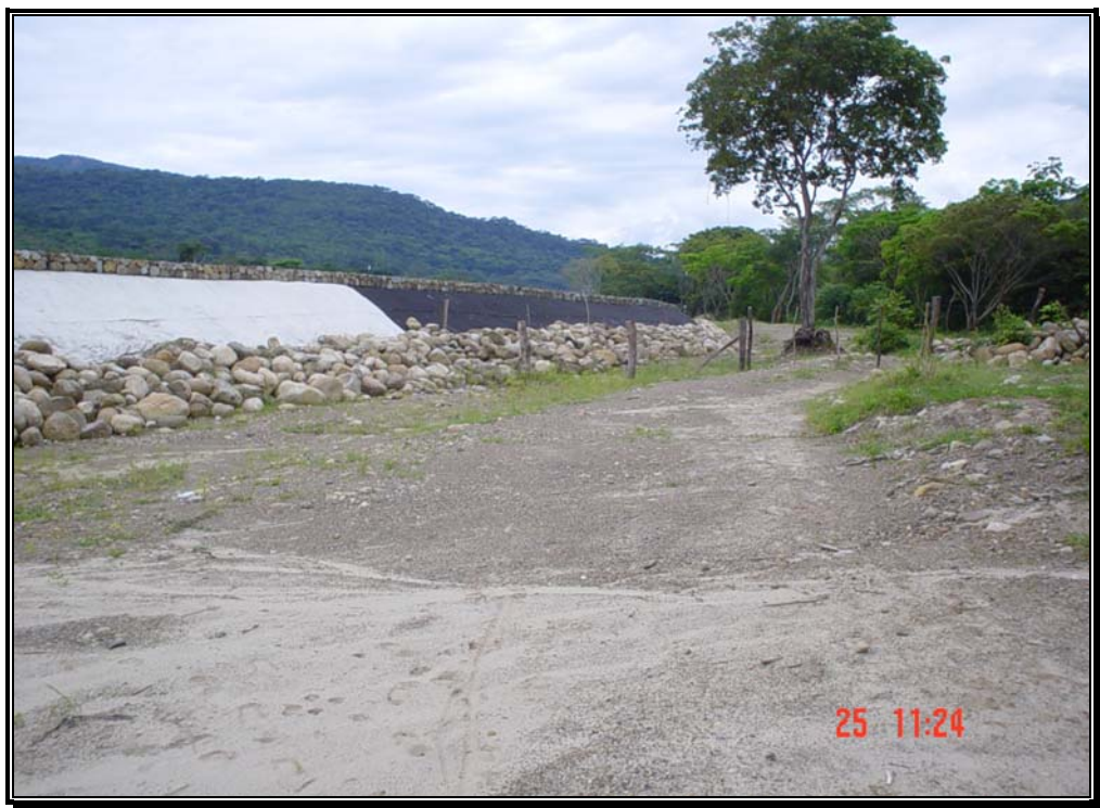
Fotografía 80. Dique con colchón reno por una de las caras y grandes bloques de protección para evitar la socavación.
