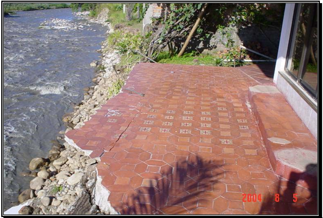
Fotografía 97. Casa en la urbanización La Casa del Río al borde del talud durante la creciente de agosto de 2004.
