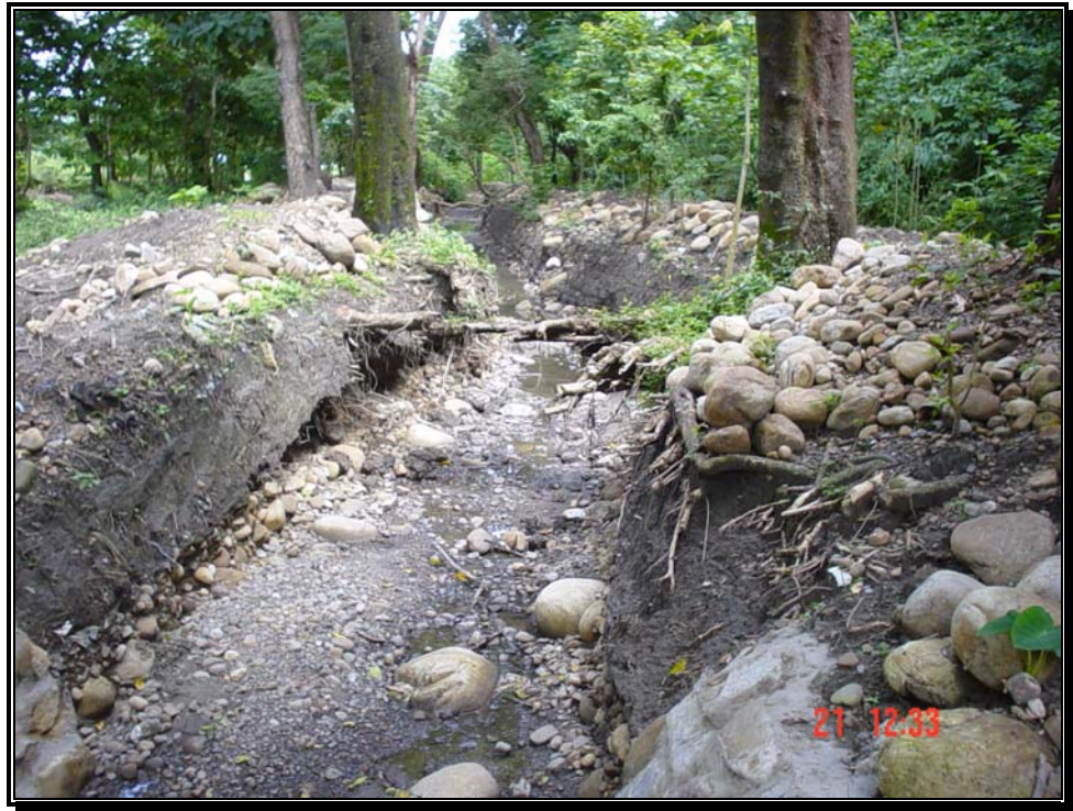
Fotografía 61. Canal en tierra para evacuar las aguas lluvias de Yopal hasta el río Cravo Sur.
