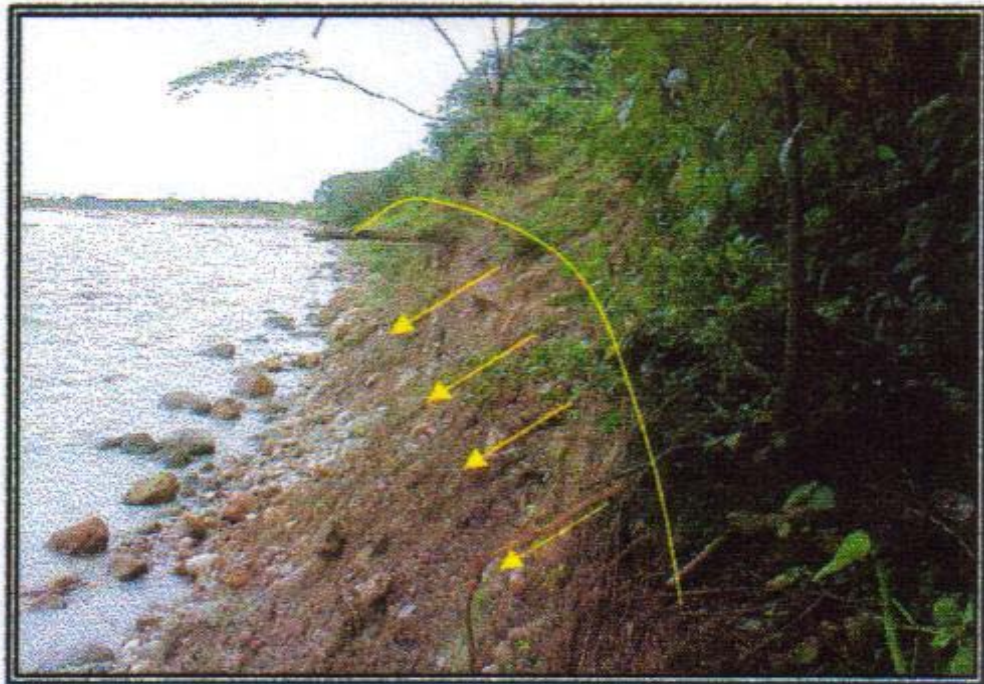
Fotografía 41. Talud de la margen derecha del río, que manifiesta fuertes niveles de agresión, cuya evolución se presenta en desprendimiento y caída de material.
