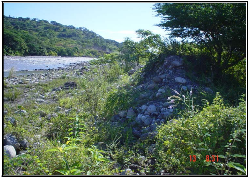
Fotografía 62. Dique de material para proteger las barras del parque de La Iguana, ubicado cerca del sitio de bocatoma.
