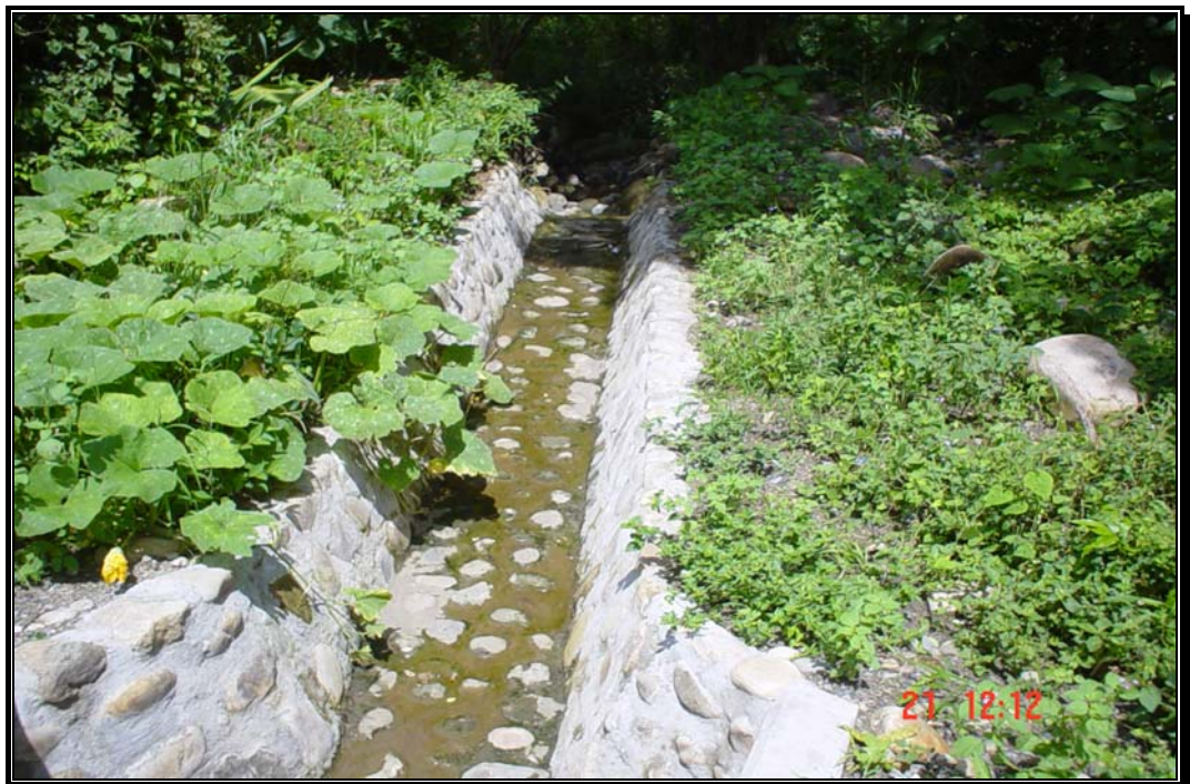
Fotografía 60. Canales de drenaje en piedra concreto para evacuar las aguas lluvias de Yopal y construidos en el Parque de La Iguana.
