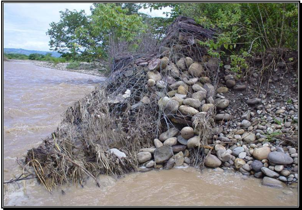
Fotografía 103. Gavión colapsado y con desalojo de material en el río Pauto.
