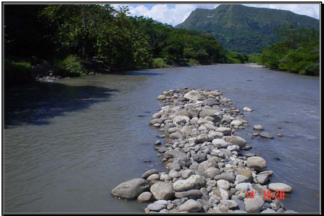
Fotografía 66. Jarillón para permitir captar el agua al canal y Bocatoma de El Remanso.
