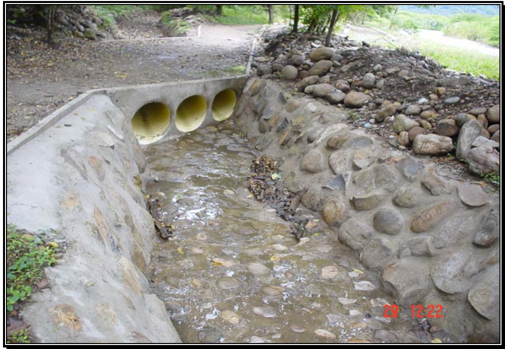
Fotografía 87. Tubería que se puede colocar bajo el dique y canal en piedra concreto en la parte posterior del dique de protección.
