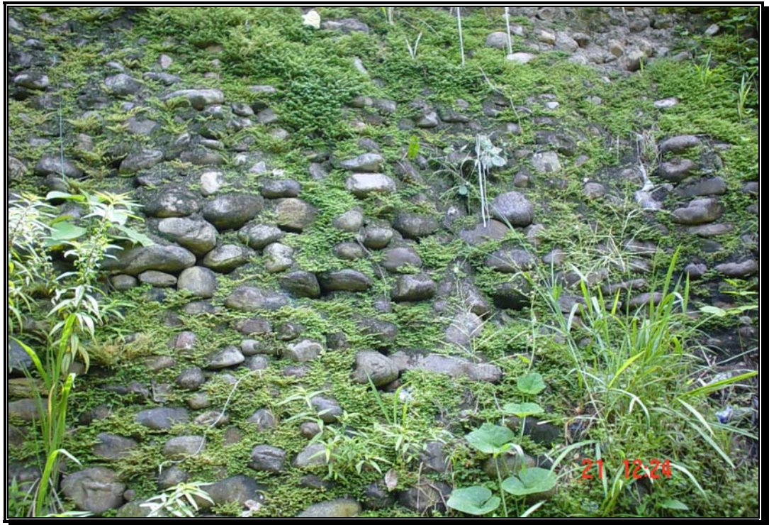
Fotografía 59. Obra de protección en piedra incrustada y algo de cemento frete al Parque de La Iguana.
