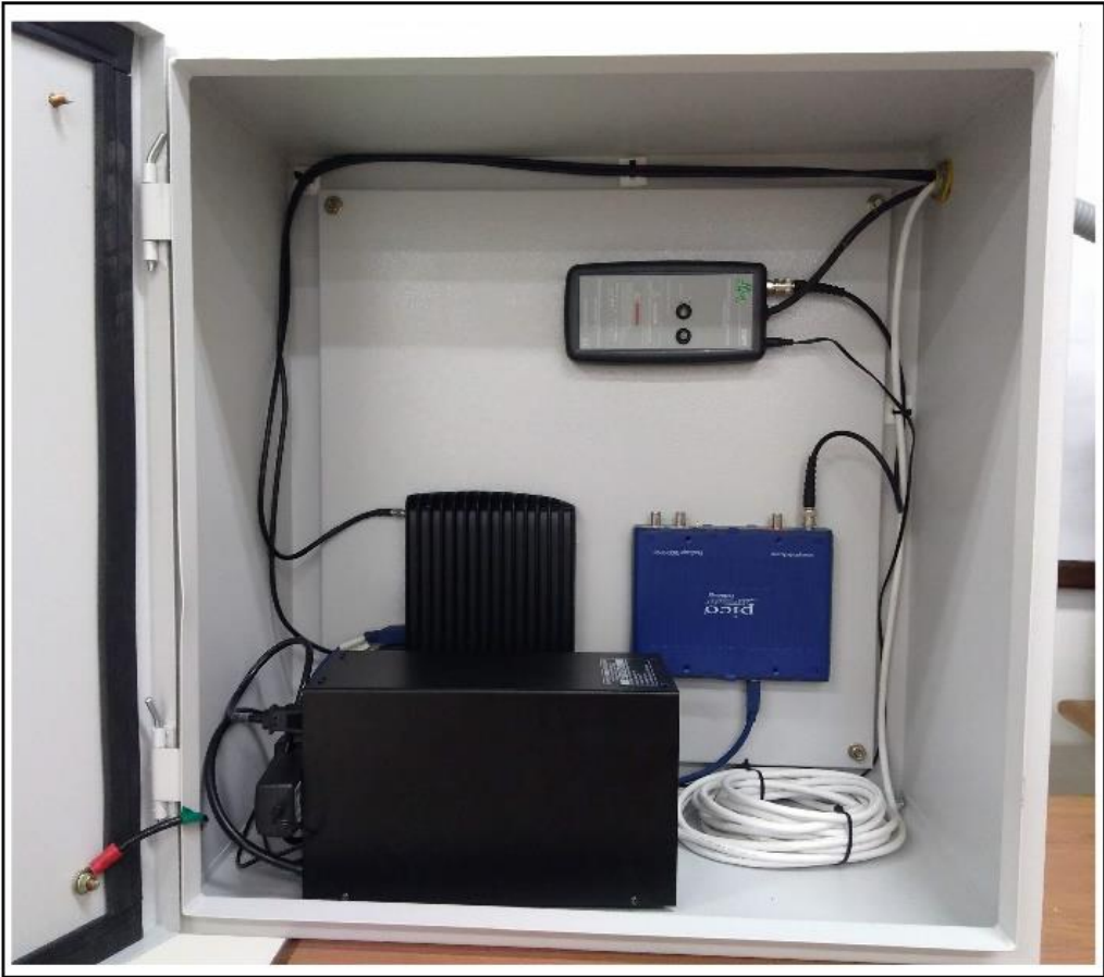
FIGURA 23: Dispositivo de medición de corriente de rayo
