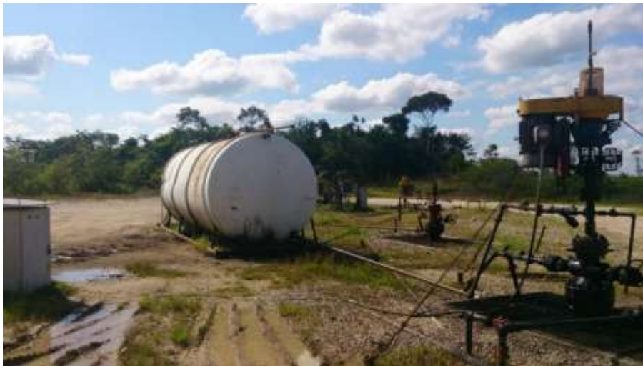
Figura 1. Montaje de producción por bomba PCP, pozo “Salina 63”
