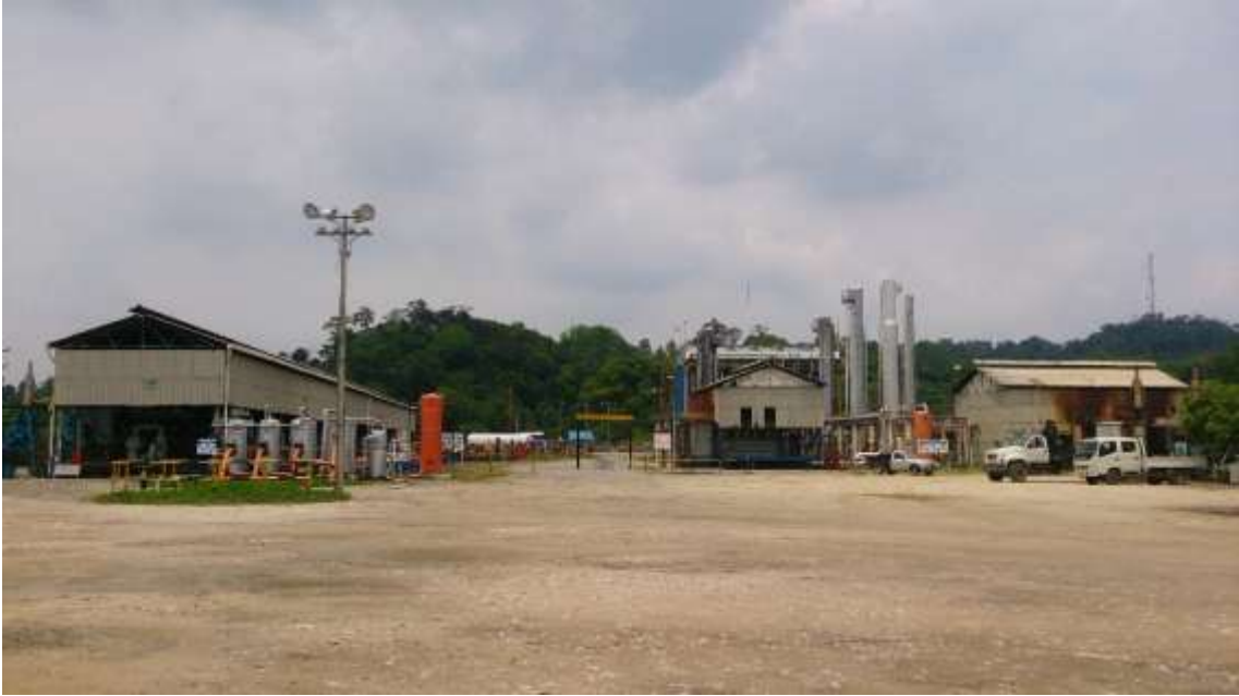
Figura 88. Tren de compresores (a la izquierda), compresores refrigerantes (en el medio) y tren de generadores (a la derecha)
