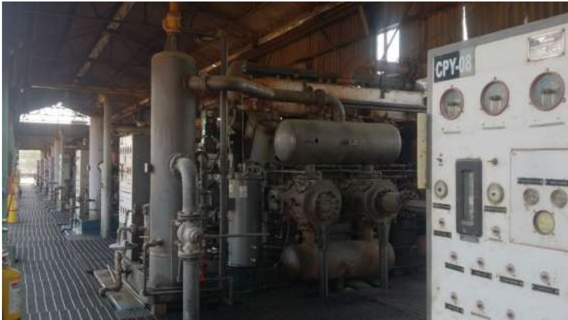
Figura 85. Tren de compresores zona industrial payoa
