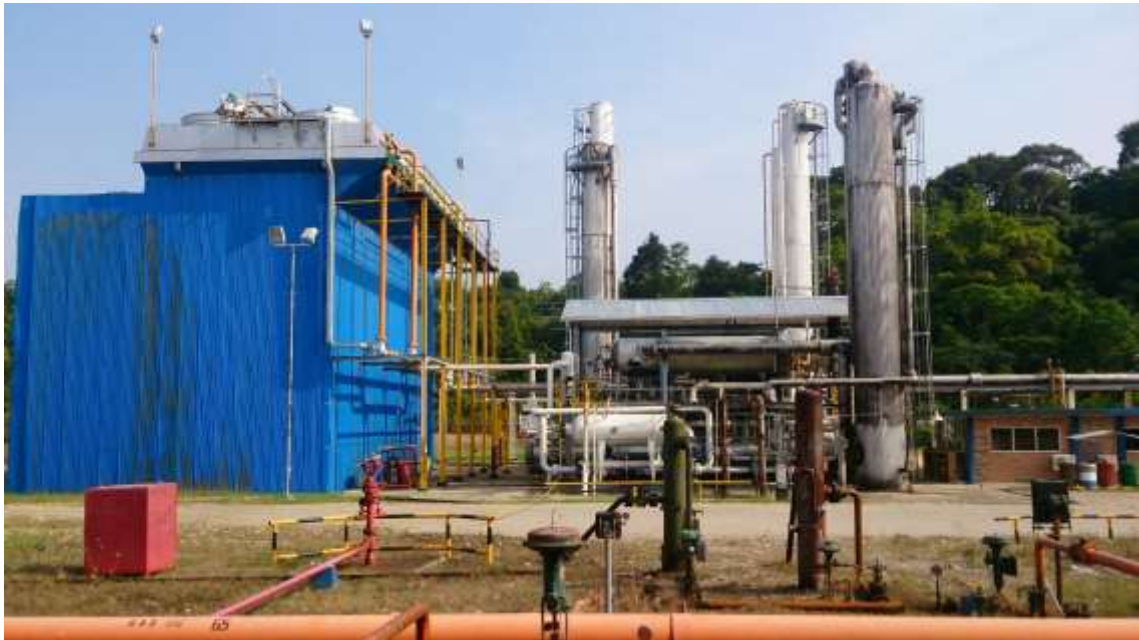
Figura 5. Torre de enfriamiento (a la izquierda) y planta de gas (a la derecha)
