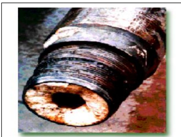
Figura 4. Taponamiento de tubería por arena
