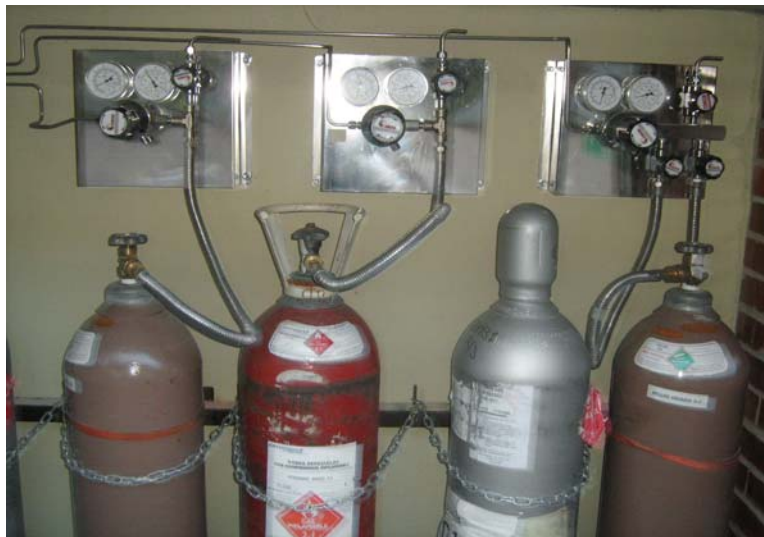
Figura 5. Detalle configuración de las Líneas de Transporte de gases Patrón y Gases Consumibles.
