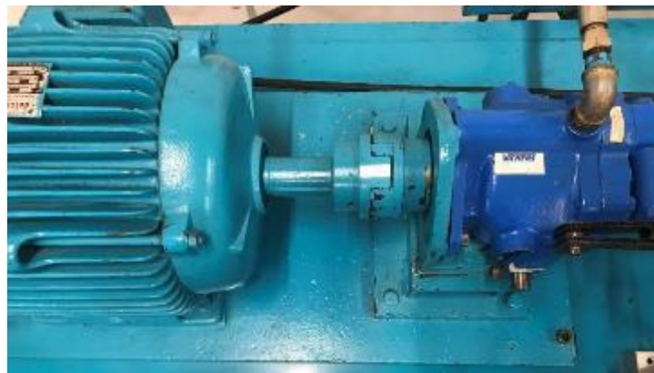
Figura 8. Motor eléctrico - Bomba Variable
