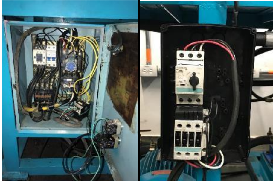
Figura 6. Arrancadores de la precarga, motor-bomba y suministro
