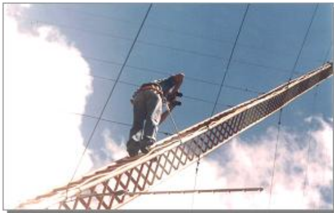
Foto No. 1 Estructura del mástil ubicado en Cerro La Puente. En la fotografía el Ingeniero está verificando la línea de vista de los enlaces.
