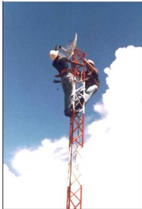
Foto No. 3. Alineamiento de la antena de grilla parabólica ubicada en el Edificio Corporativo Cañaveral.
