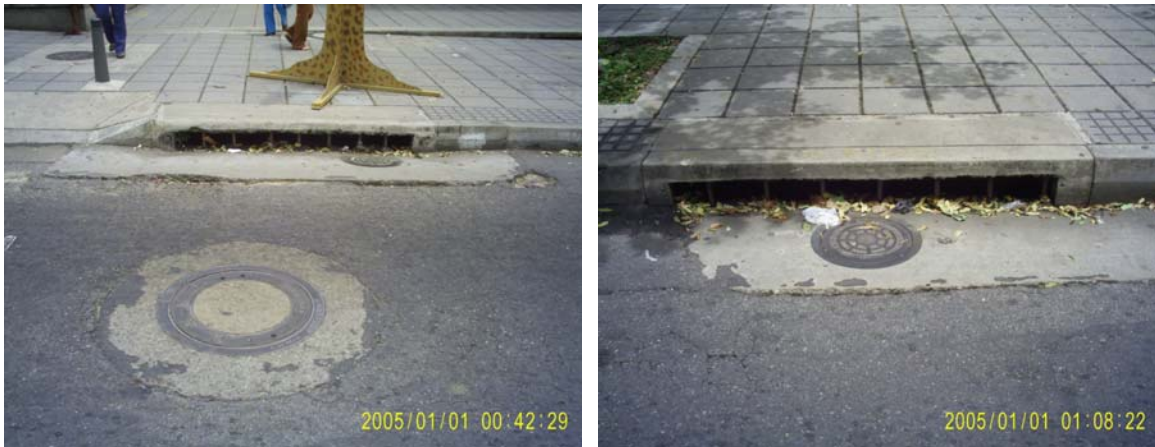
Figura 2. 4 Colectores de drenaje laterales calzada N-S
