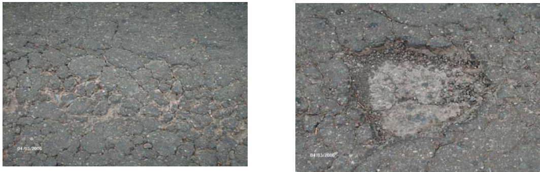
Figura 3. 2 Desprendimiento de la capa de rodadura. K0+250
