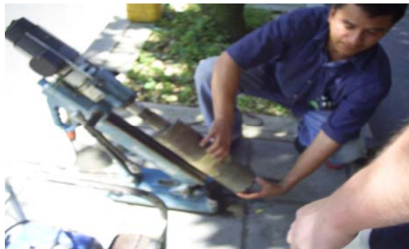
Figura 3. 11 Foto tomada durante el proceso de corte y extracción de muestras para las dos calzadas.
