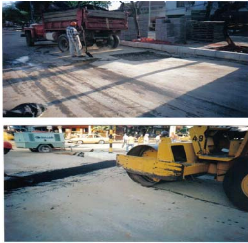
Figura 2. 7 Bacheo transversal y Afectadas de la calzada N-S.
