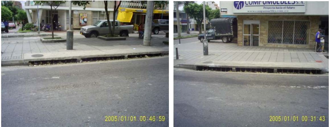
Figura 2. 3 Colectores de drenaje laterales calzada S-N
