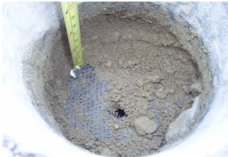
Figura 3. 13 Detalle de espesor de la Base y geotextil trenzado utilizado en la calzada S-N.
