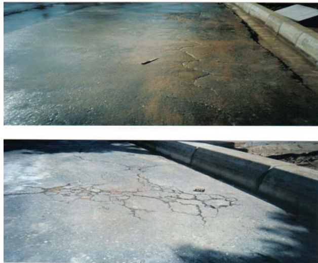
Figura 2. 6 Estado inicial de la calzada N-S antes del inicio de las obras
