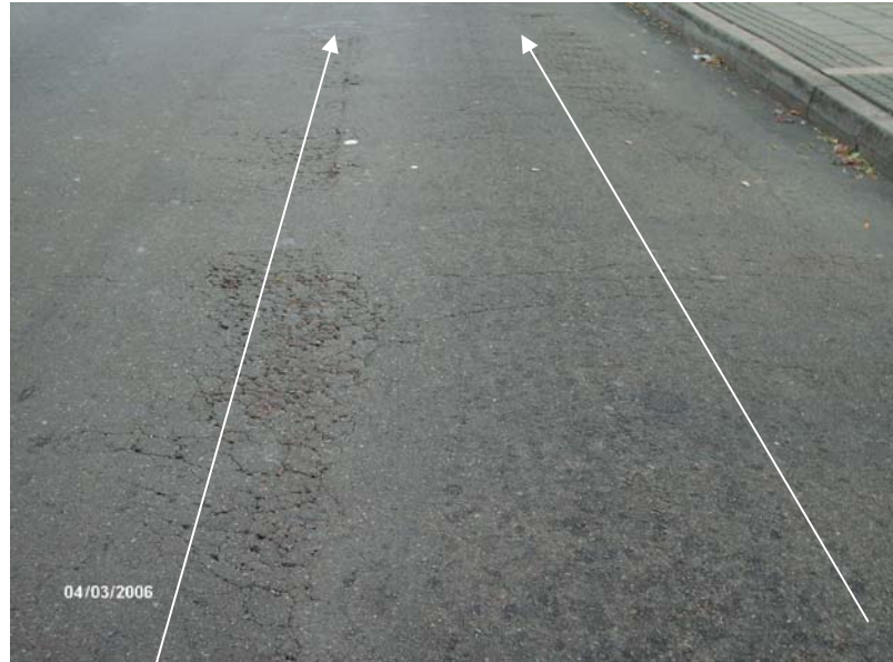
Figura 3. 1 Fallas tipo piel de cocodrilo a lo largo de la calzada Norte-Sur. K0+180.
